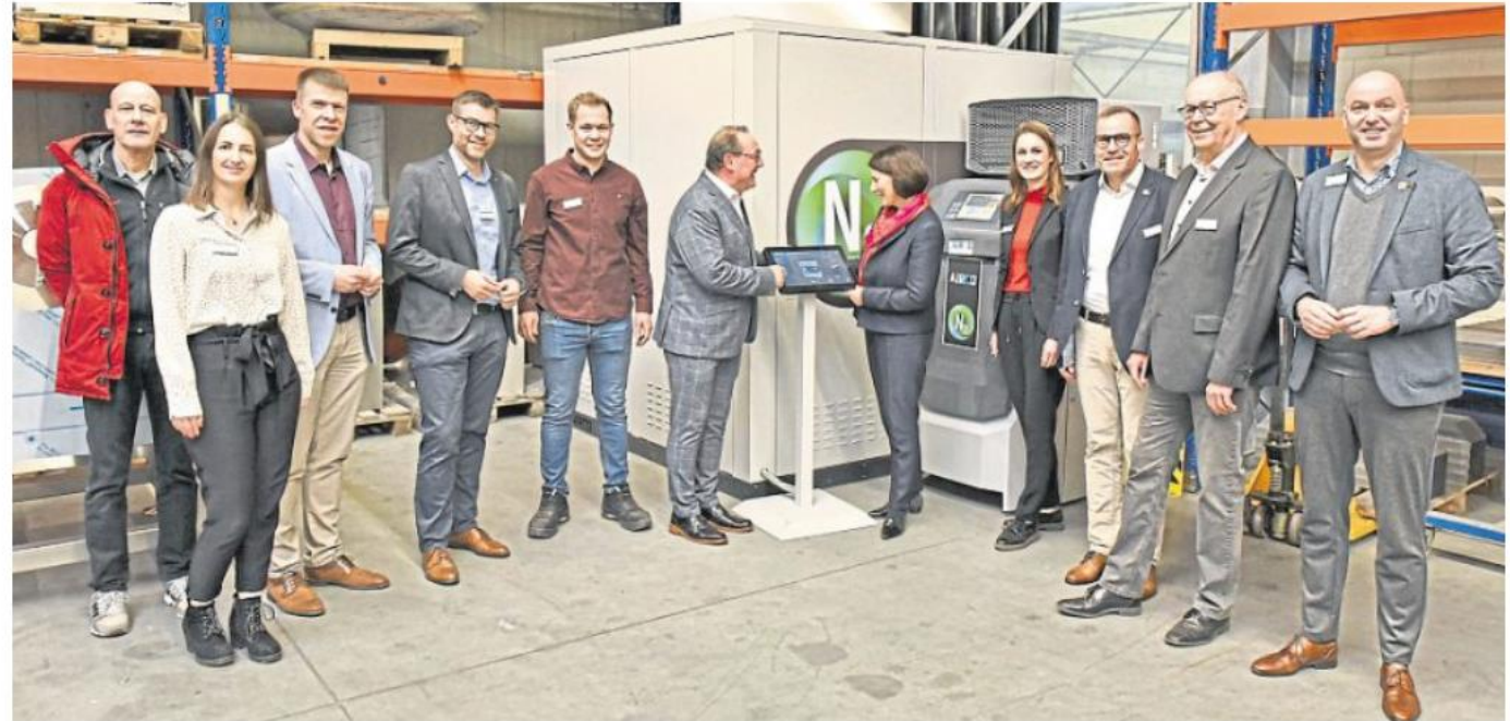
Sie steht beispielhaft für die Innovationskraft der MST Graffe GmbH Langenlonsheim: die Stickstoff-Gewinnungsanlage. Sie entzieht der Umgebungsluft mit firmeneigenem Solarstrom Stickstoff, der beim Laserschneiden und -schweißen als Schutzgas dient. Das beeindruckte Ministerin Daniela Schmitt (5. von rechts). Unternehmer Markus Graffe (Mitte) führte sie zusammen mit anderen Gästen durch den 1989 gegründeten Betrieb.
